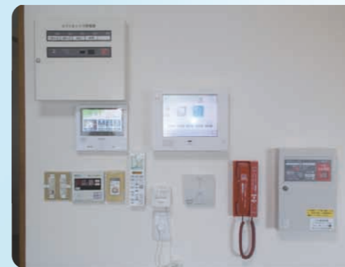
自動火災通報装置
